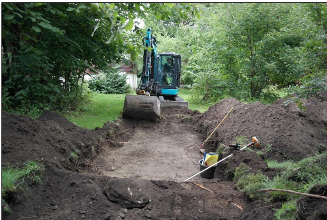
Foto 45: Sjakting i hage på gbnr. 43/11. Sett mot NØ.
